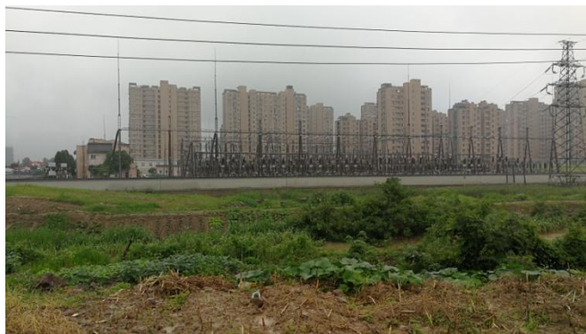
220kV 金桥变出线端
