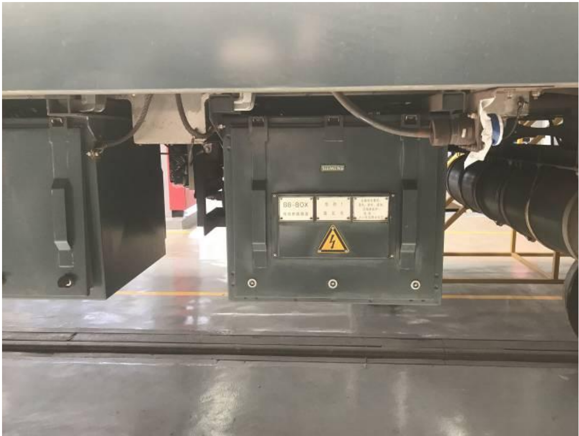
图 9-1 地铁列车蓄电池照片
