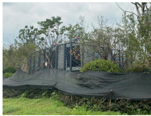
葛巷站冷却塔
