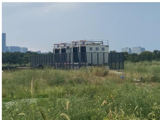
绿汀路站冷却塔
