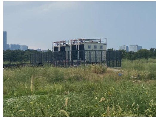
绿汀路站冷却塔
